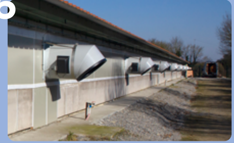
Sortie de l'air via les modules à clapets motorisés
